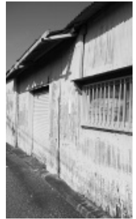
窓こしには積み上げたアスベスト織布が見える
